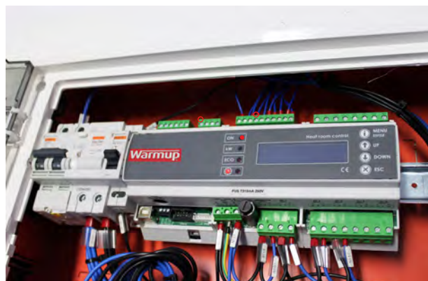
Esempio di collegamento e di gestione temperatura
